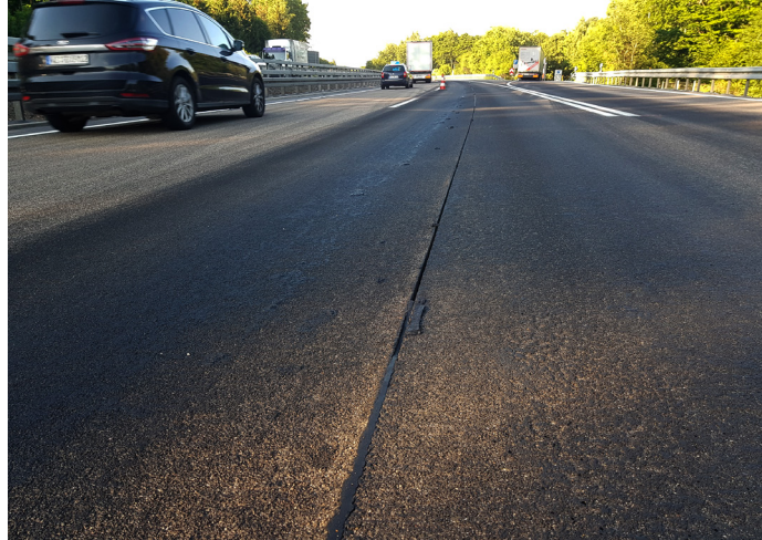
Fugenschäden nach Stau und extremer Hitze
